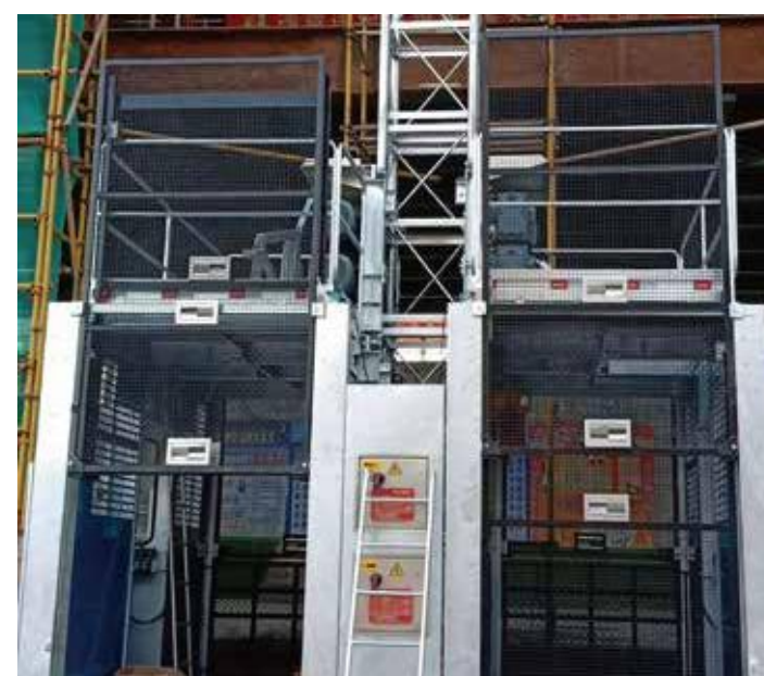
实例使用工地, 电梯运行速度可达46米每分钟
